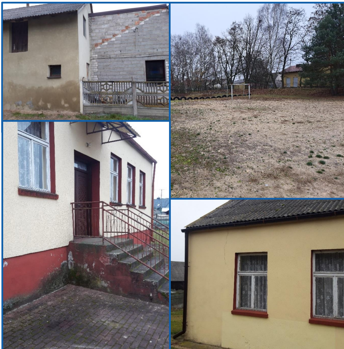
Rycina 14. Stan techniczny wybranych obiektów w obszarze rewitalizacji (budynek gospodarczy w Grabowej, tereny sportowe w Załączu Wielkim, remiza OSP w Kluskach)
